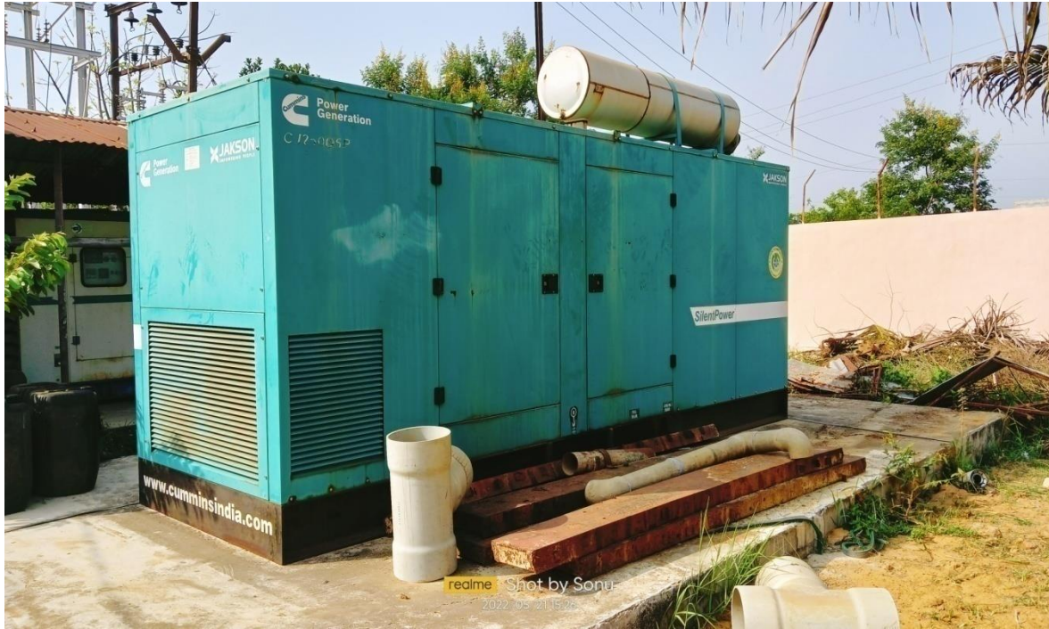
Fig:9 DG Set 250 KVA
