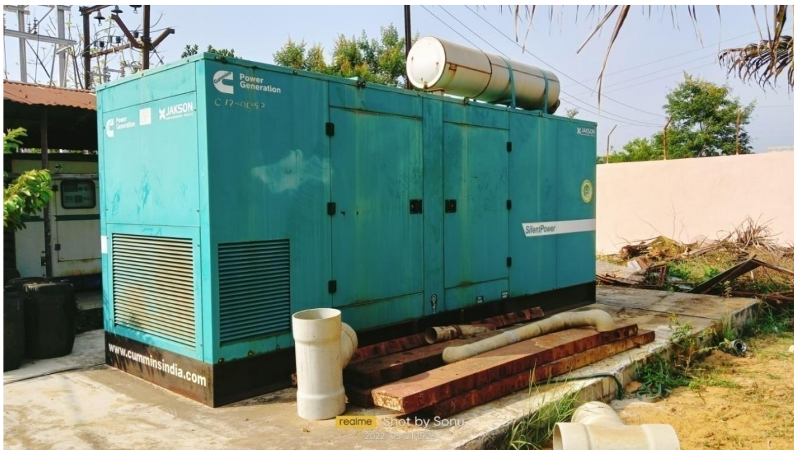
DG Set 250 KVA
