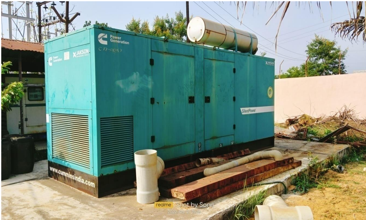
DG Set 250 KVA
